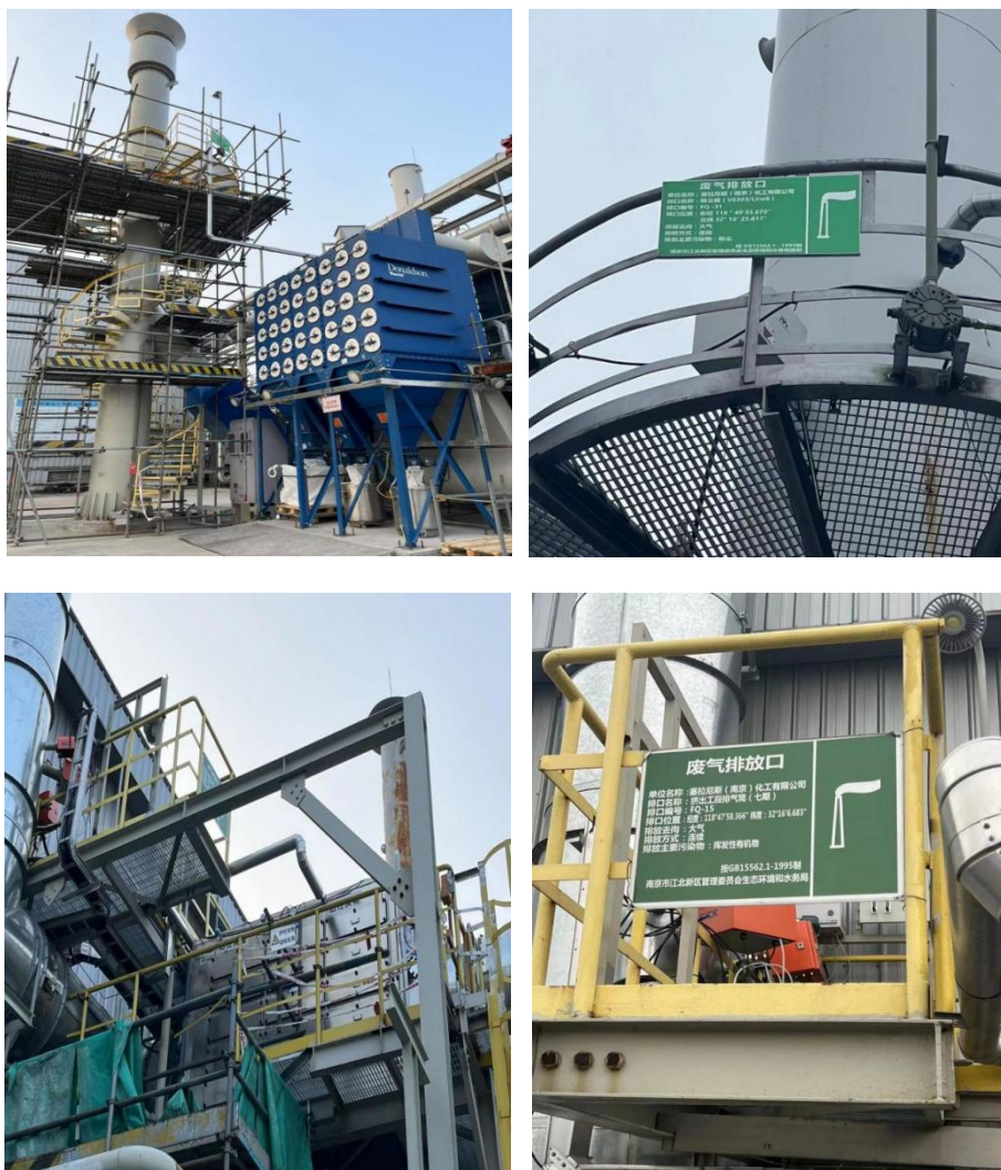
图 3-1 废气治理设施
