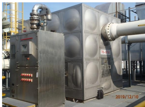
10、20、30、40 线共用分子裂解装置现状图
