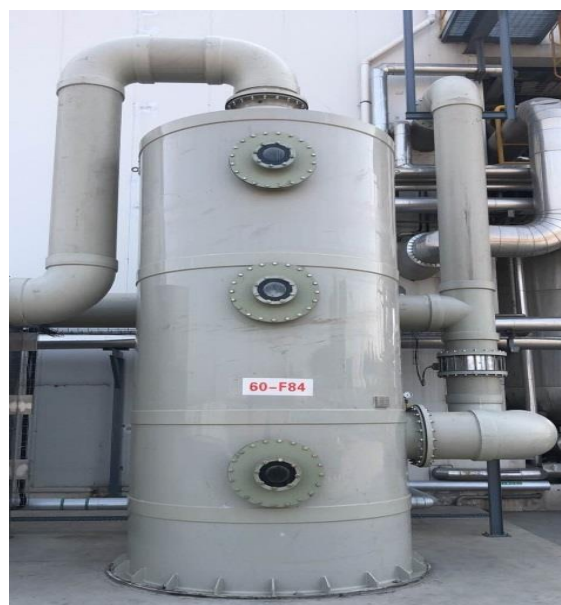
AKD 及松香线填料除雾塔
