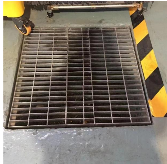
危废库收集井
